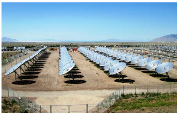
米国アリゾナに設けられた太陽熱スターリング発電施設
